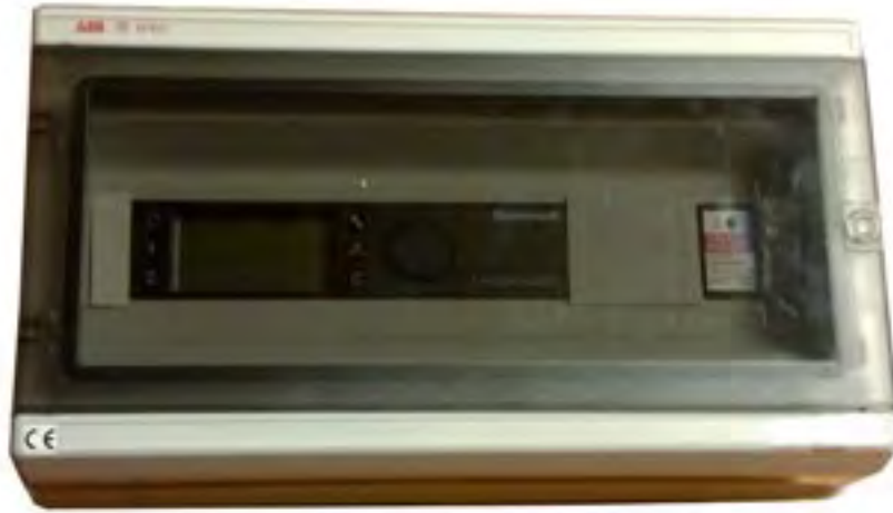
Figure 26 : Coffret de l'automate de régulation
